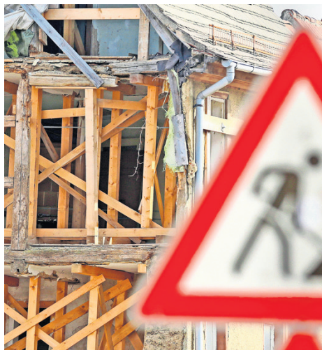
Bei der Renovierung alter Häuser gibt es nicht selten unerwartete Probleme. Foto: dpa
